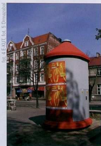
Fot. 4. Słupowa stacja transformatorowa w kształcie słupa znajdująca się w centrum miasta
