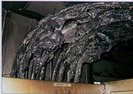
Fot. 3. Stopione kable zasilające transformator w wyniku wewnętrznego zwarcia łukowego w rozdzielni
