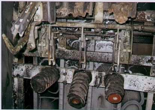
Fot. 2. Uszkodzony rozłącznik SN w wyniku wewnętrznego zwarcia łukowego w rozdzielni
